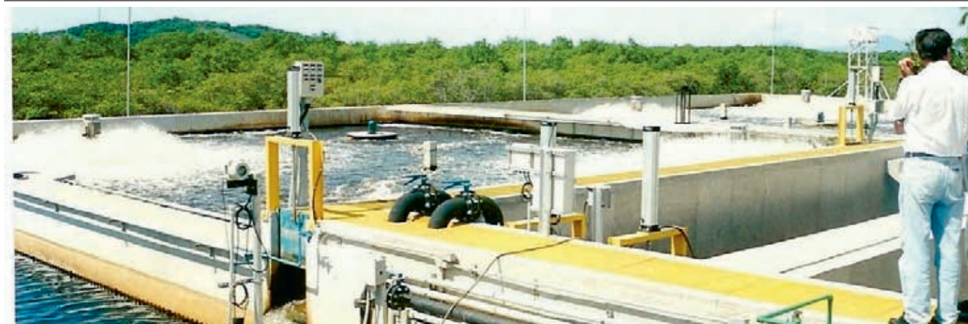
Vista de trecho da ETE Anchieta. Fonte: PMI.
